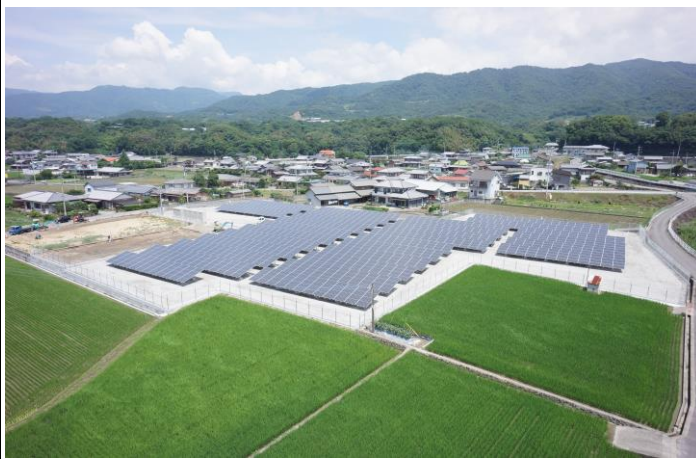
太陽光発電所
